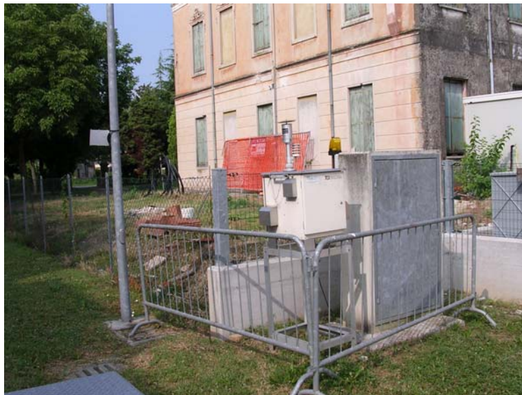
Foto 1: Stazione rilocabile posizionata a Cessalto
