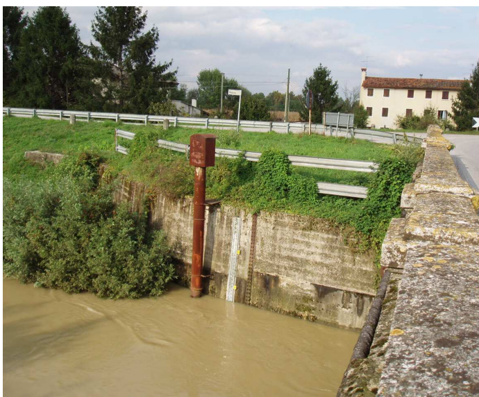
Foto 9 Malgher a Corbolone: asta idrometrica (28 settembre 2007)
