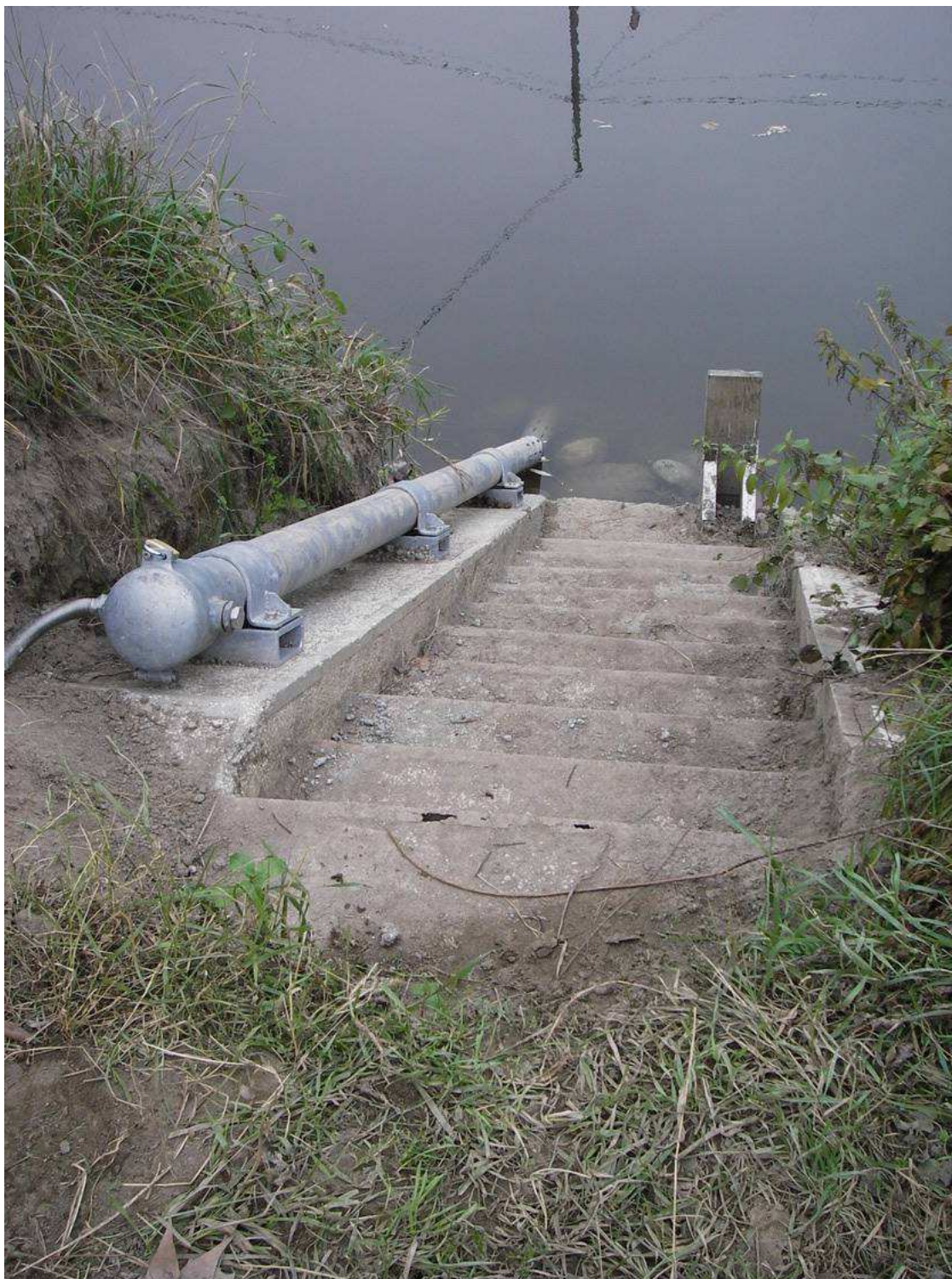
Foto 1 – Nuova stazione piezometrica sul fiume Gorzone a Stanghella
