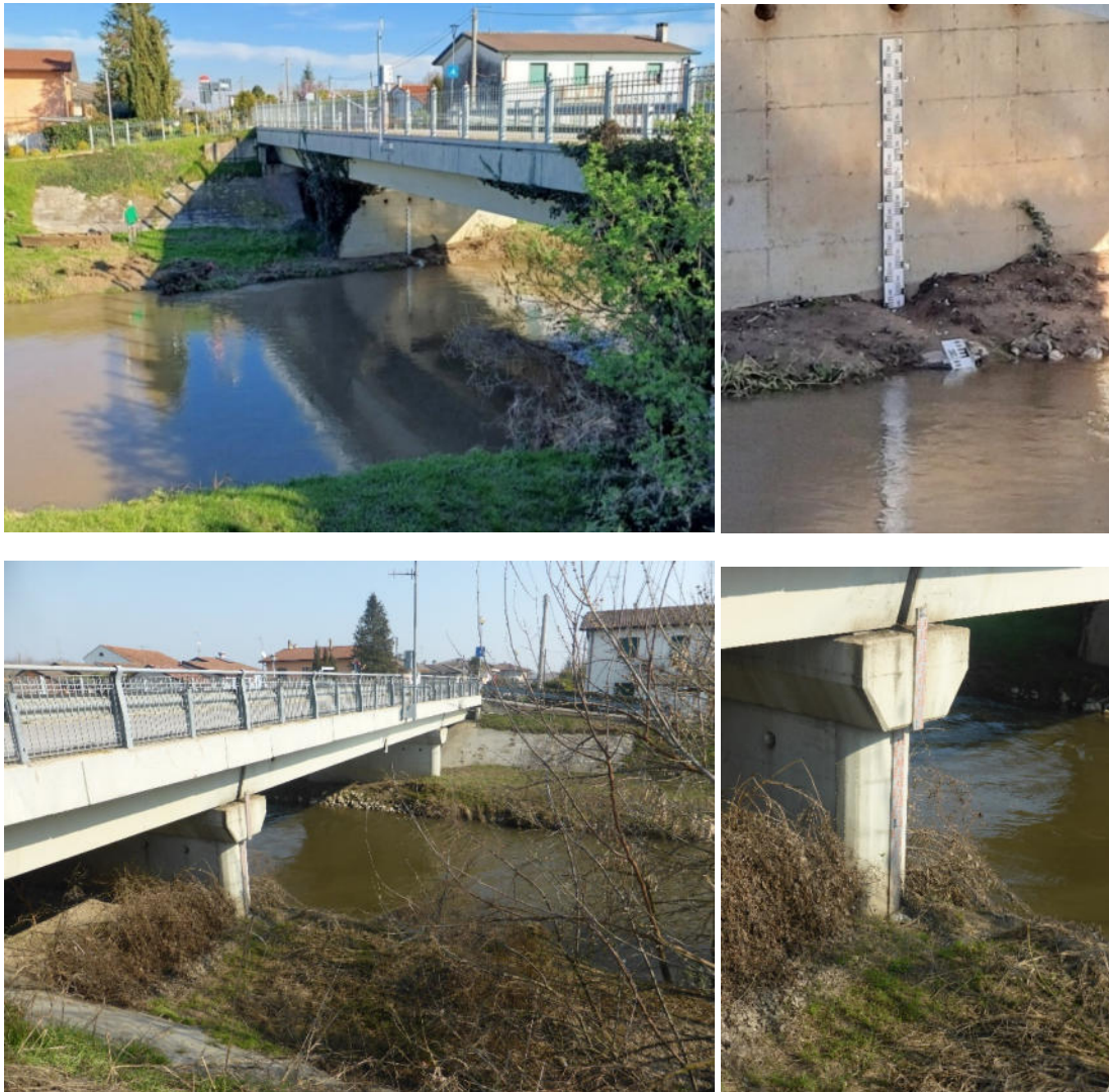
Figura 9 – Aste idrometriche per il controllo dei livelli, in alto l'asta di magra collocata al di sotto della campata del ponte sulla spalla sinistra, in basso quella di piena situata in spalla destra lato valle.
