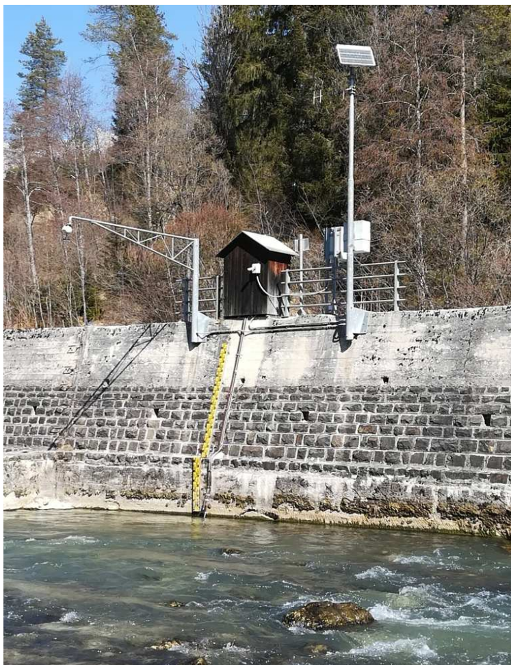
Figura 2 – Torrente Boite, stazione idrometrica di Cancia: teleidrometro radar per la registrazione dei livelli idrometrici e asta centimetrata, installati sul muro di sponda sinistra
