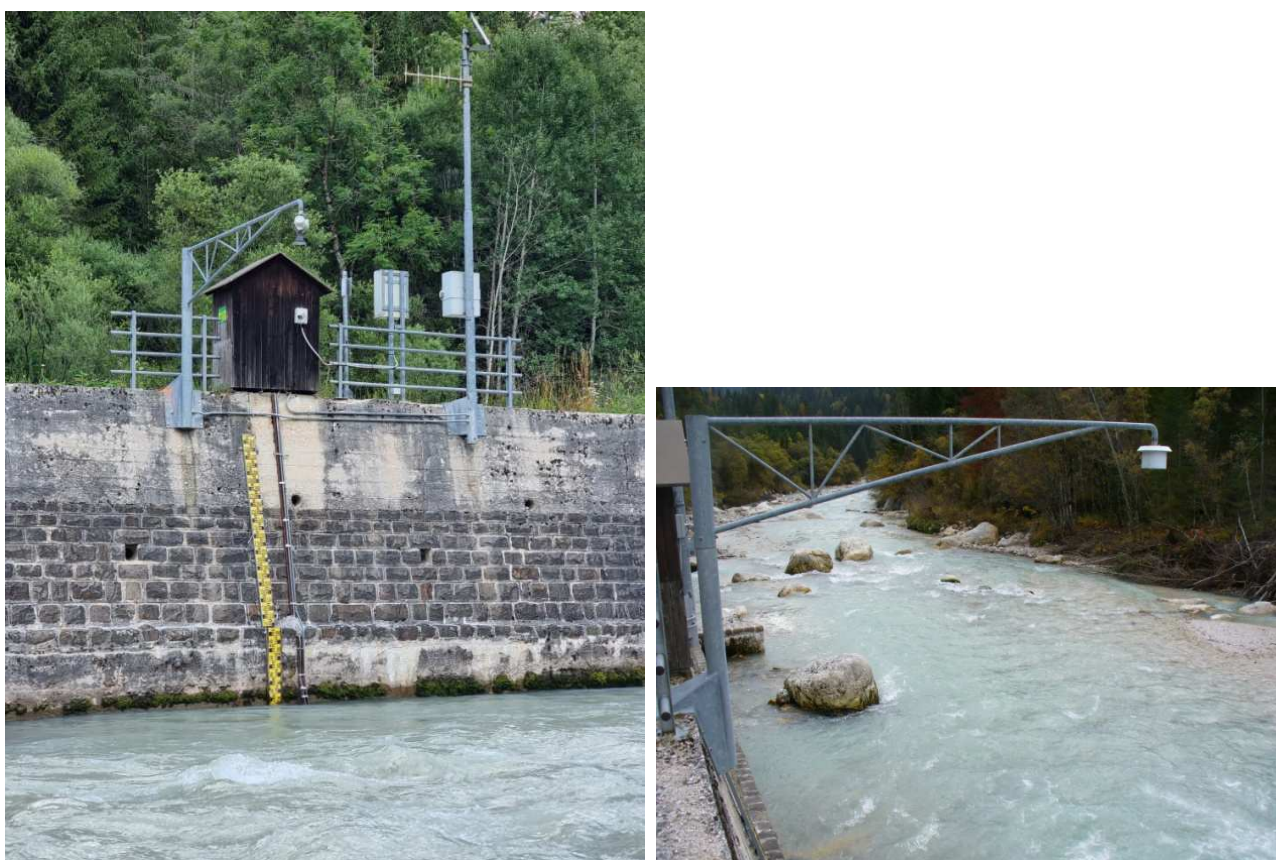
Figura 3 – Torrente Boite, stazione idrometrica di Cancia: tele idrometro radar per la registrazione dei livelli idrometrici installati sul muro di sponda sinistra
