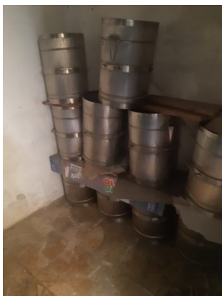
Foto 10/b – centrale termica
