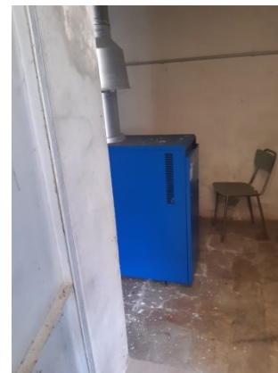
Foto 10/a – centrale termica
