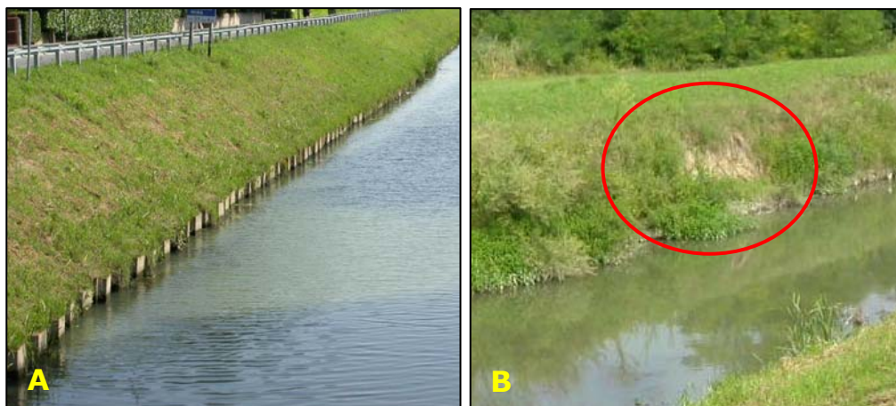
Figura 13 – (A) Esempio di intervento per contrastare l'erosione sul Taglio di Mirano (B) Sponda parzialmente franata sul Muson Vecchio
