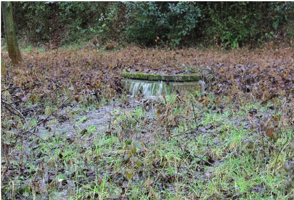
Fig.5: Pozzettone con deflusso causa piena (25/12/2010 ore 10:30)
