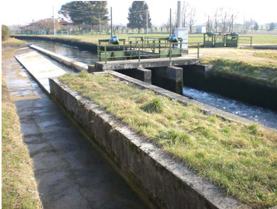
Figura 8. Nodo idraulico di diversione della Roggia Isacchina dal Canale Unico.
