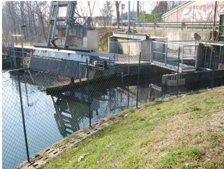
Figura 11. Sistema di regolazione mediante paratoie autolivellanti presente lungo il Canale Unico in località Crosara. Tale opera regima le portate turbinate attraverso una centralina ad acqua fluente.
