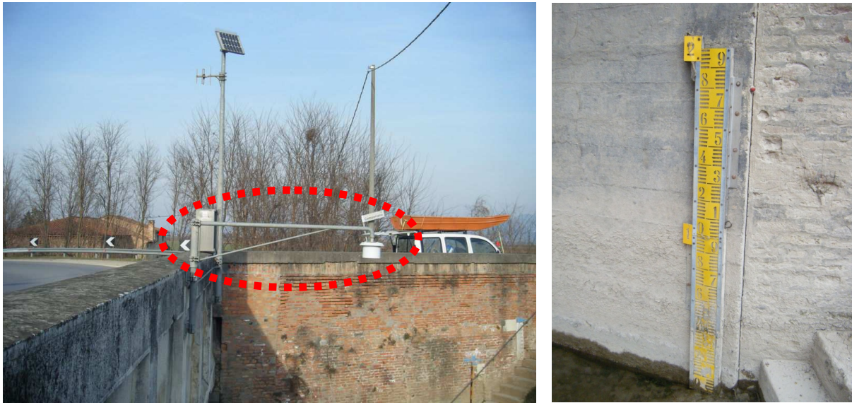
Figura 2 – Fiume Frassine a Borgofrassine: teleidrometro ad ultrasuoni installato sul ponte (a sinistra) e asta idrometrica per il controllo dei livelli di magra, adiacente alla spalla del ponte (a destra)
