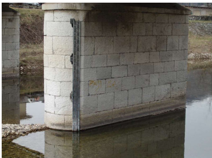
Figura 6 – Torrente Agno a Ponte Brogliano: asta idrometrica installata su una pila del ponte
