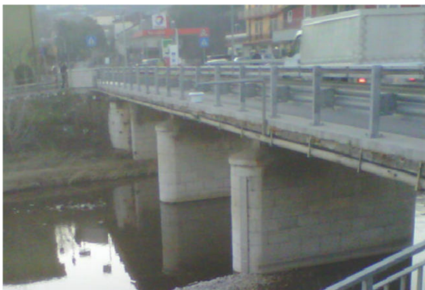
Figura 5 – Torrente Agno a Ponte Brogliano: teleidrometro ad ultrasuoni fissato al centro del ponte
